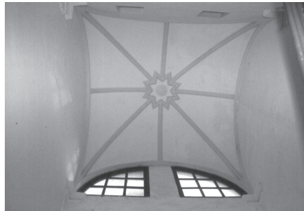
Fondón. Casa señorial en la C/ Agua. Bóveda de la caja de escalera.
